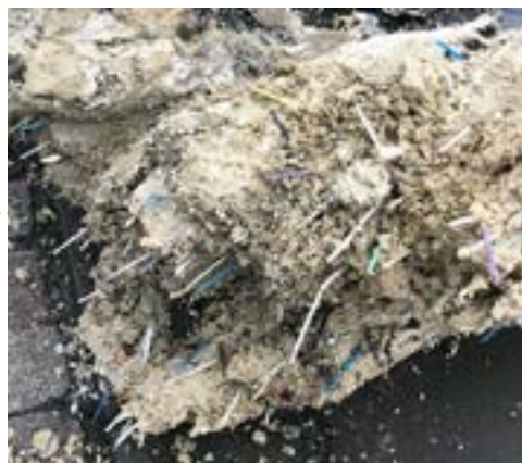
En läskigt hård klump av fett och tops, som skapat stopp i en ledning.
